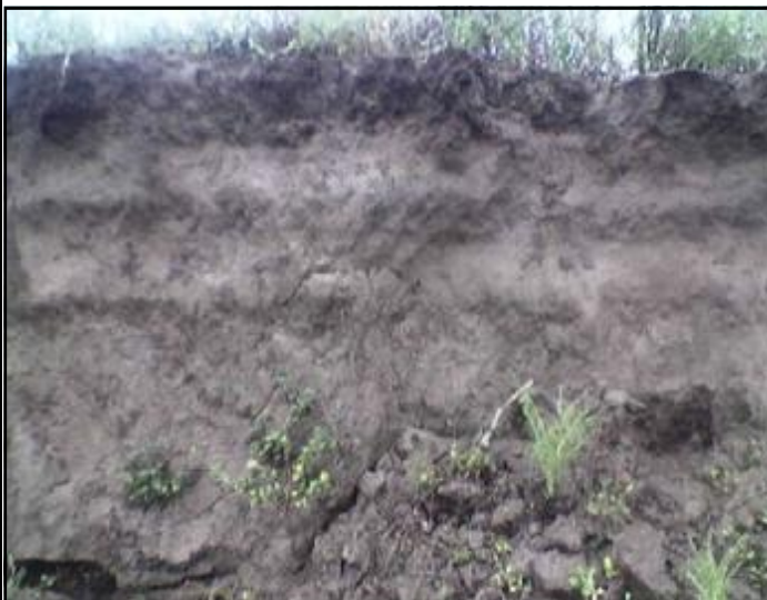
Vista parcial da margem esquerda do rio Revúbuè (área do regadio) com a encosta evidenciando sinais de fissuras
